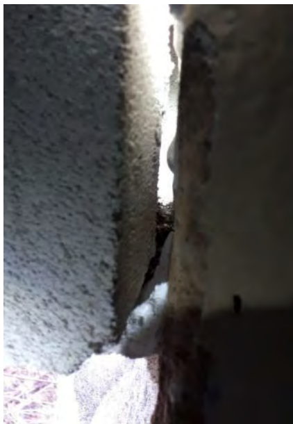
Spalte im Verwaltungsgebäude mit Fledermauskot
