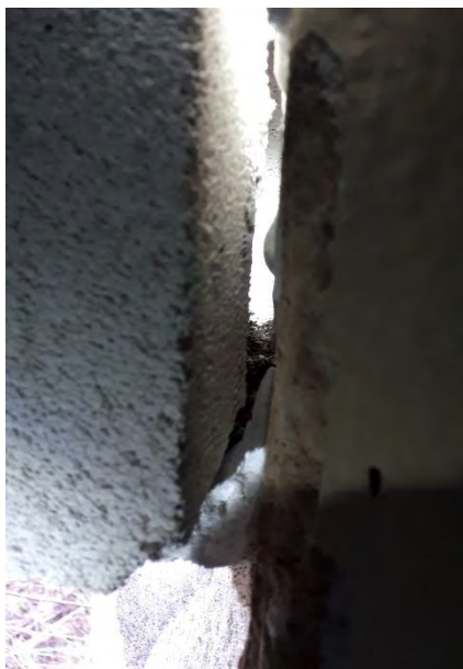
Spalte im Verwaltungsgebäude mit Fledermauskot
